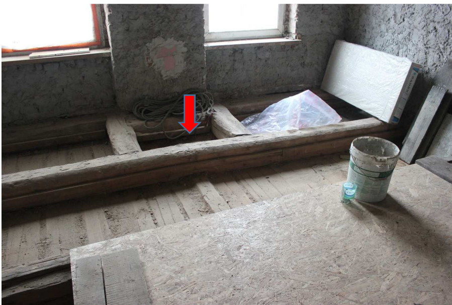
Fot. 7 - pęknięta „górną” na podporze belka stropowa
