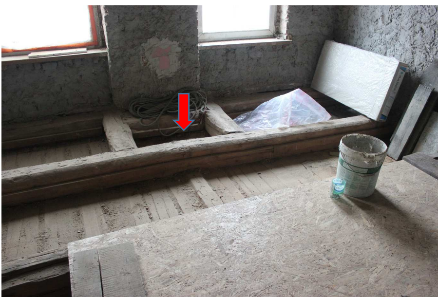
Fot. 7 - pęknięta „górną” na podporze belka stropowa
