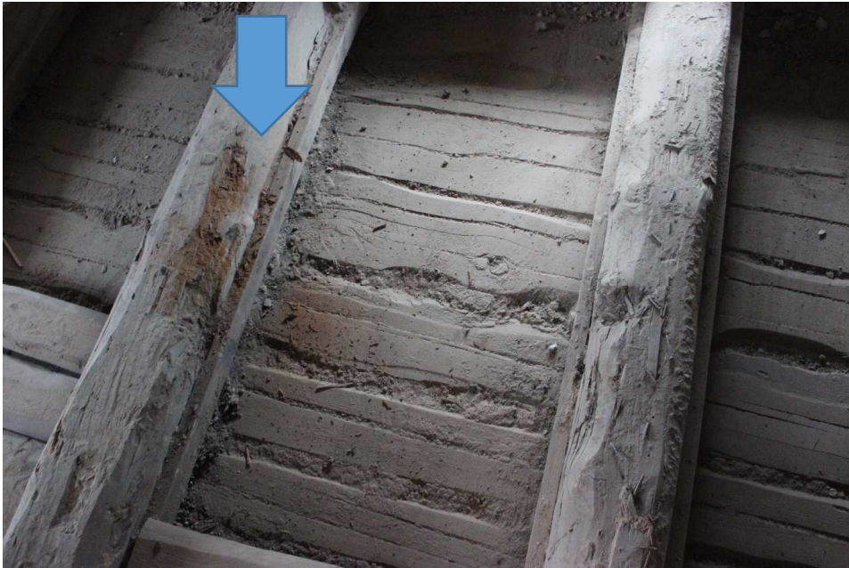
Fot. 8. – miejscowe uszkodzenie
