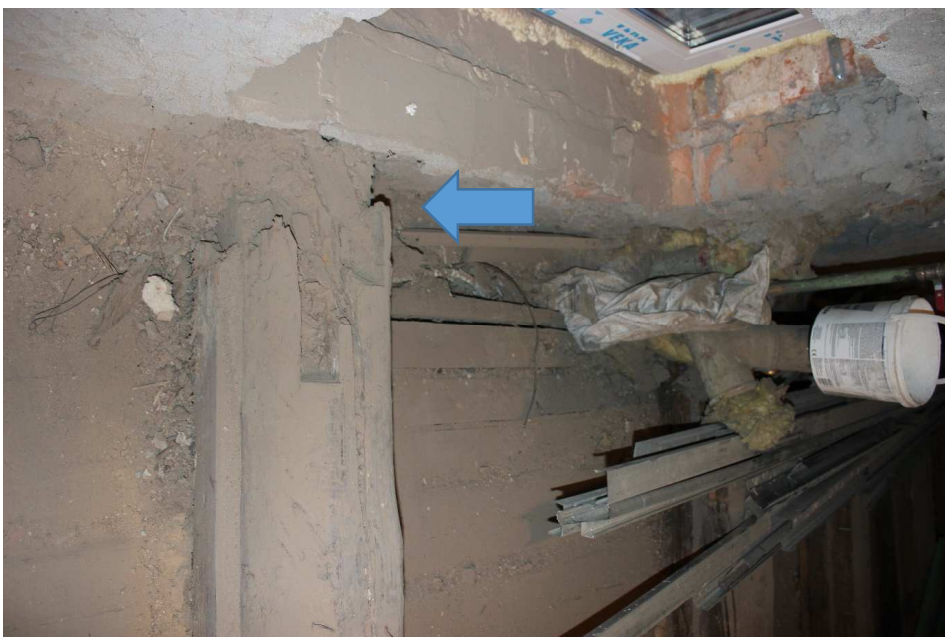
Fot. 2 - zdegradowana końcówka belki stropowej
