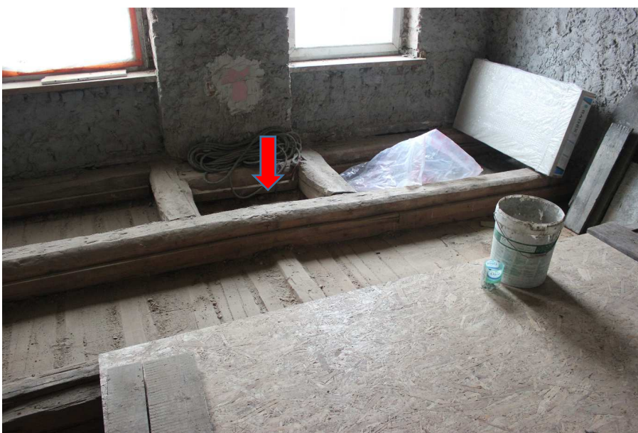
Fot. 7 - pęknięta „górną” na podporze belka stropowa
