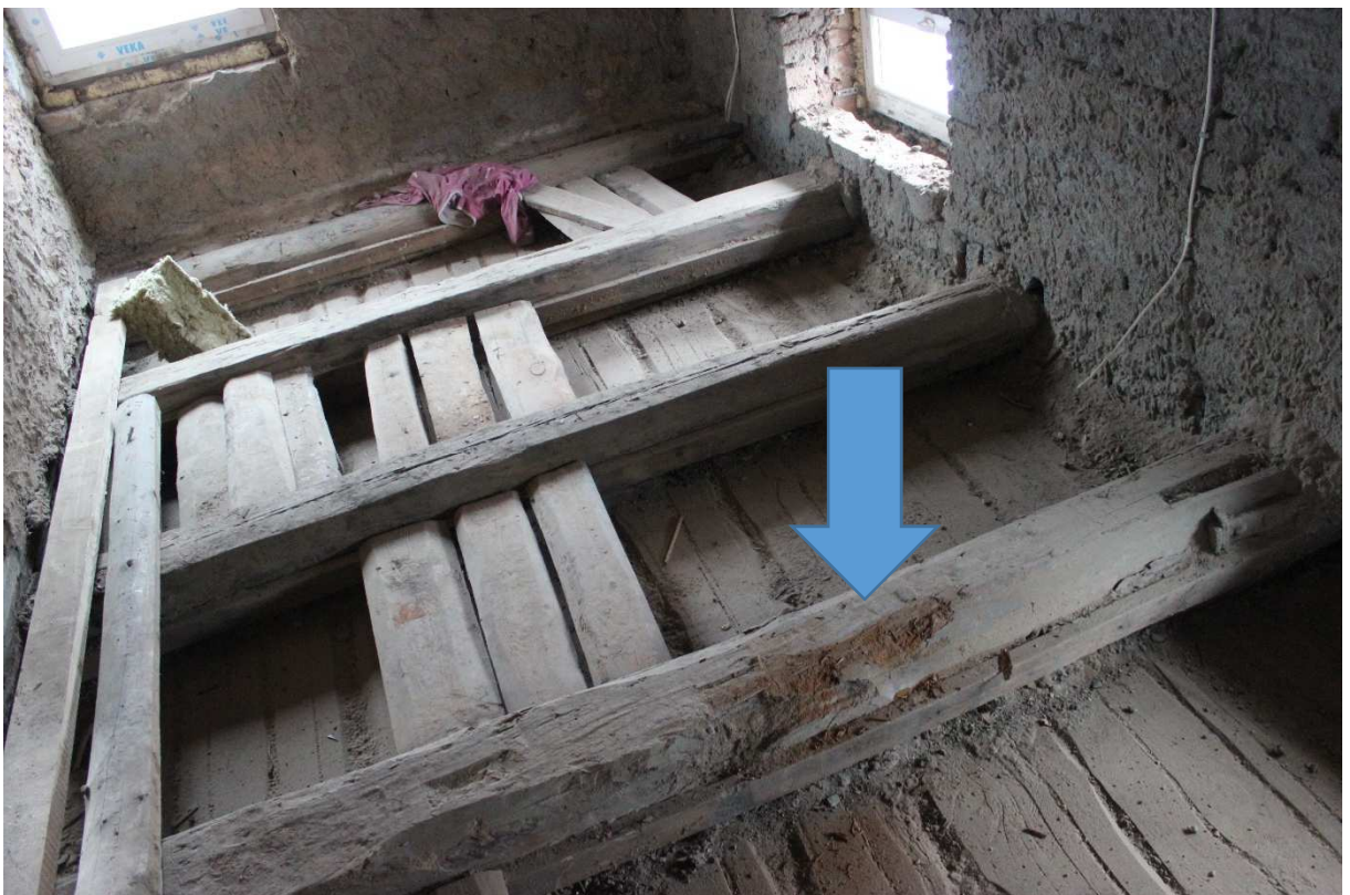
Fot. 9 – miejscowe uszkodzenie
