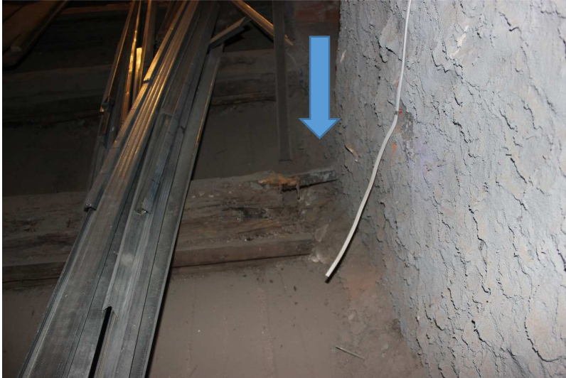
Fot. 1 – zgniła końcówka belki stropowej, widoczna kotwa stalowa wystająca z muru
