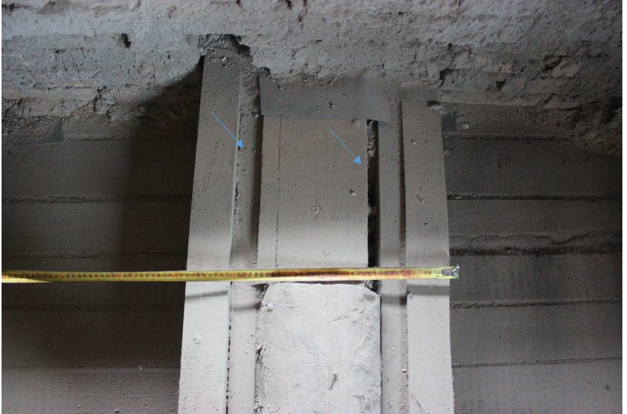
Fot. 6 – niedokładnie spasowane końcówki, widoczne szczeliny, jakies deski, łaty – takie połączenie nie zapewnia „konkretnego” sprężenia zapobiegającego obrotowi przekroju
