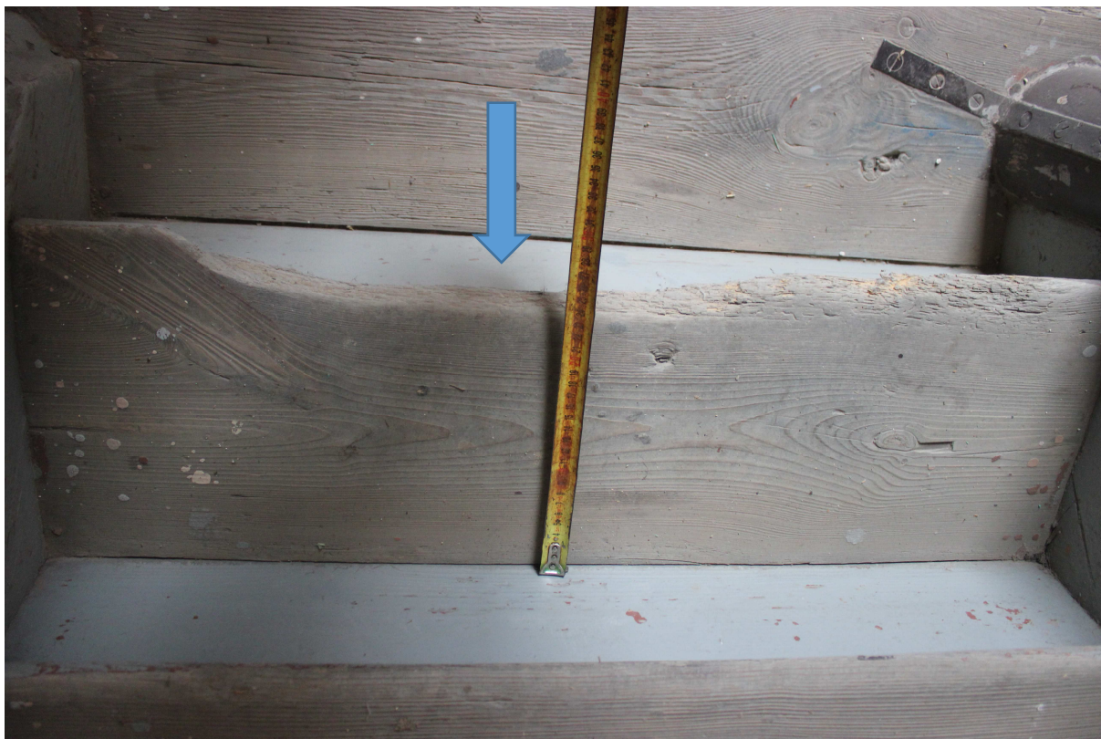
Fot. 11 – uszkodzone „wyszczerbione” stopnie schodowe
