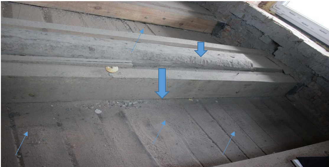
Fot. 3 – widoczne wzmocnienia belek stropowych dodatkowymi nakładkami obustronnie, skreconymi na śruby SPAX
