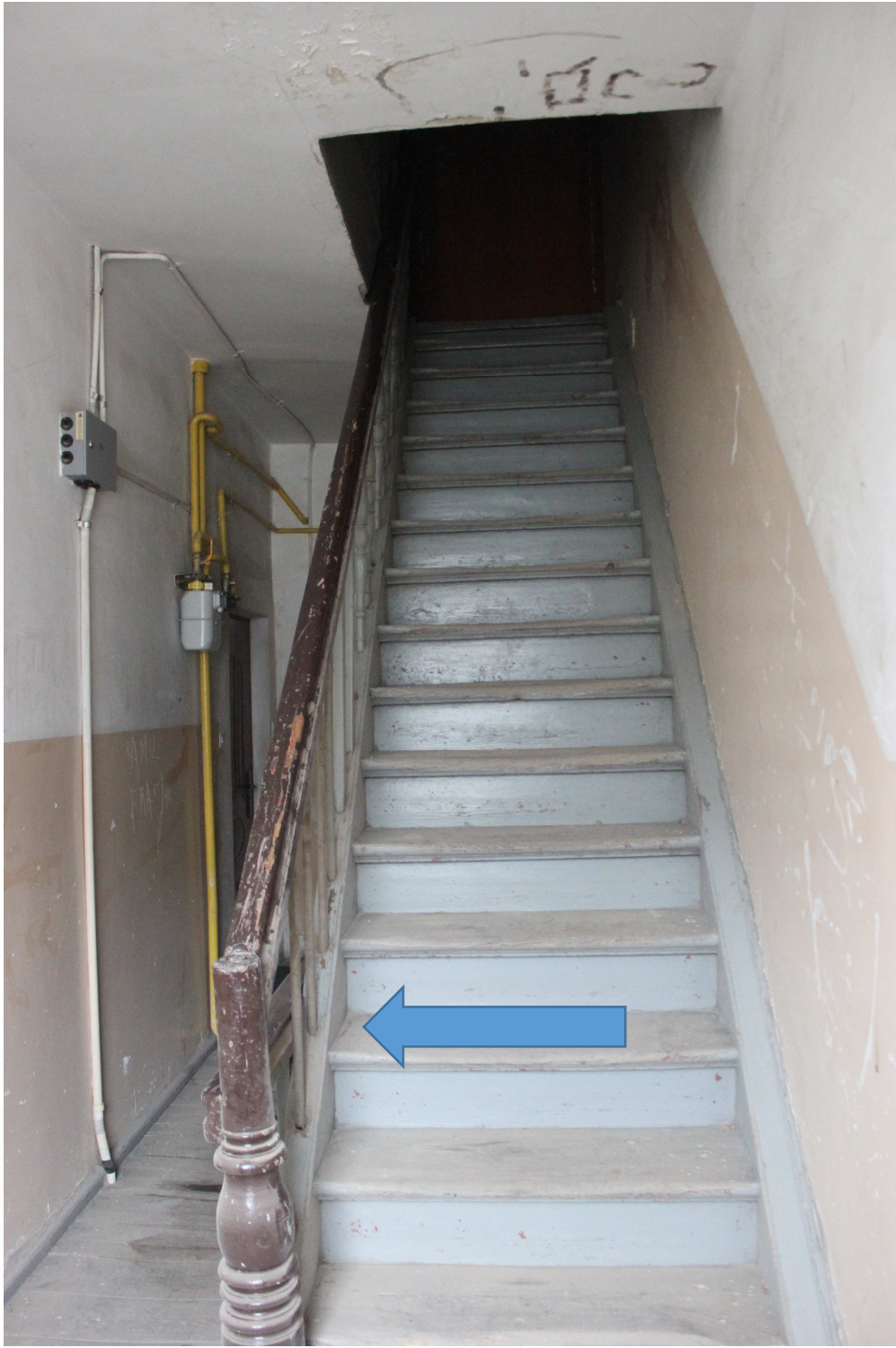
Fot. 10 – uszkodzone tralki
